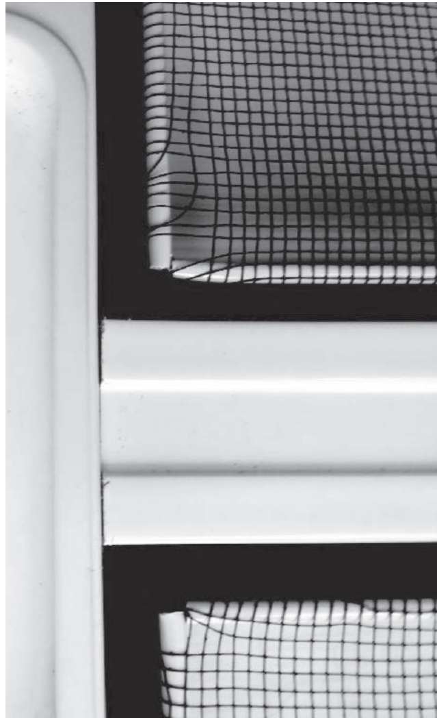
Abbildung 15: Verarbeitungsfehler oben: unzulässige Abweichung unten: zulässige Abweichung
